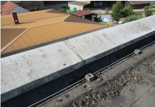
Abbildung 13: undichte Fuge Attika OG 2
