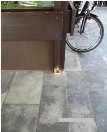
Abbildung 9: beschädigter Pfosten Fensterfront Eingangsbereich
