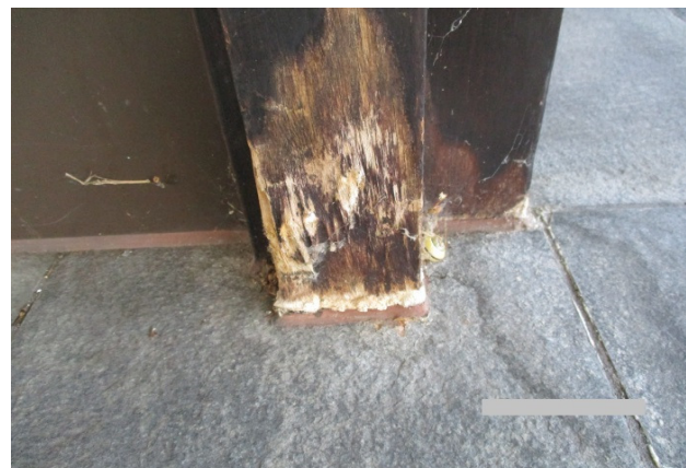
Abbildung 10: beschädigter Pfosten Fensterfront Eingangsbereich
